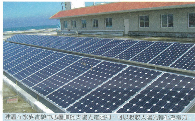
建置在水族實驗中心屋頂的太陽光電組列，可以吸收太陽光轉化為電力。
