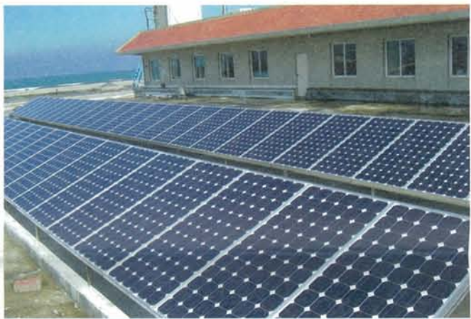
建置在水族實驗中心屋頂的太陽光電組列，可以吸收太陽光轉化為電力。
