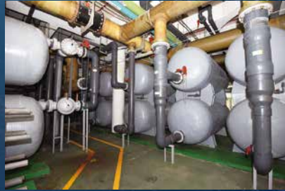
大洋池的高壓石英沙過濾器
