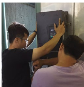
水族中心空調箱變頻器更新。
