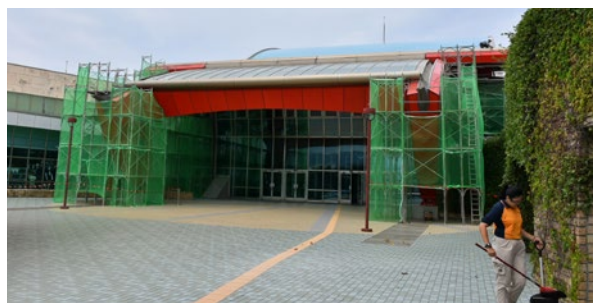
鯨魚廣場側珫瑯板漏水維修。
