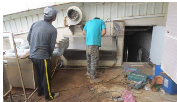
二研屋頂消防排煙煙罩。
