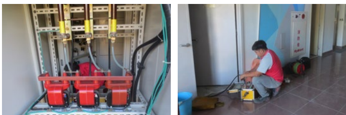
高低壓電力巡檢維護保養。
