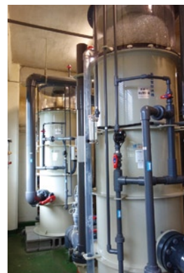
▲圖4. 增設蛋白除沫設備。
